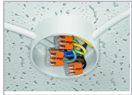
Leuchtenverteilung in Deckenbaldachin
